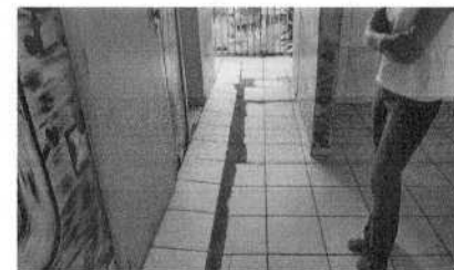
LOCAL PARA CORREÇÃO DO PISO
